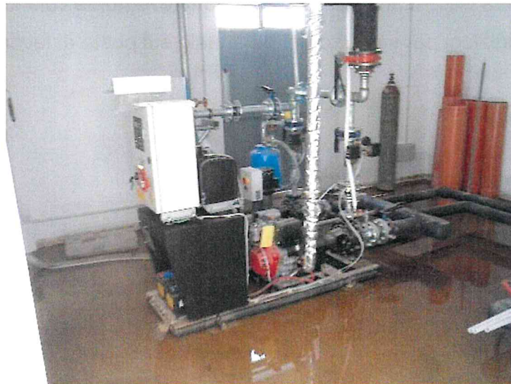
Stazione antincendio (locale nel resede pertinenziale)
