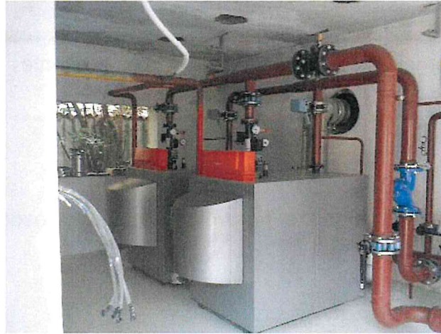
Zona Caldaia (locale nel resede pertinenziale)
