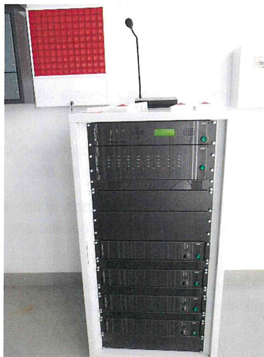
Sistema EVAC e sinottico camere c/o la portineria
