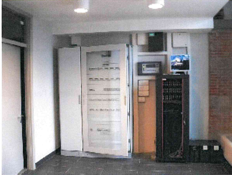
Quadro elettrico generale in corrispondenza della portineria
