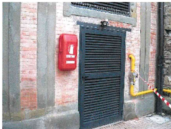
Saracinesca Gas Metano nel retro del fabbricato (in corrispondenza della caldaia)
